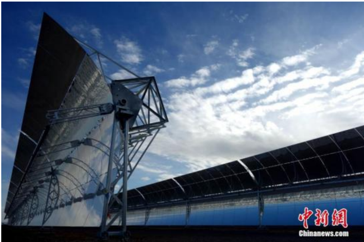
材料图：位于柴达木盆地之中广核德令哈50兆瓦光热发电项目槽式抛物面集热器阵列。中新社记者 孙睿 摄
